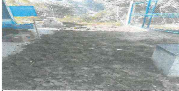
TORTA DE CONCRETO EN EL PATIO
